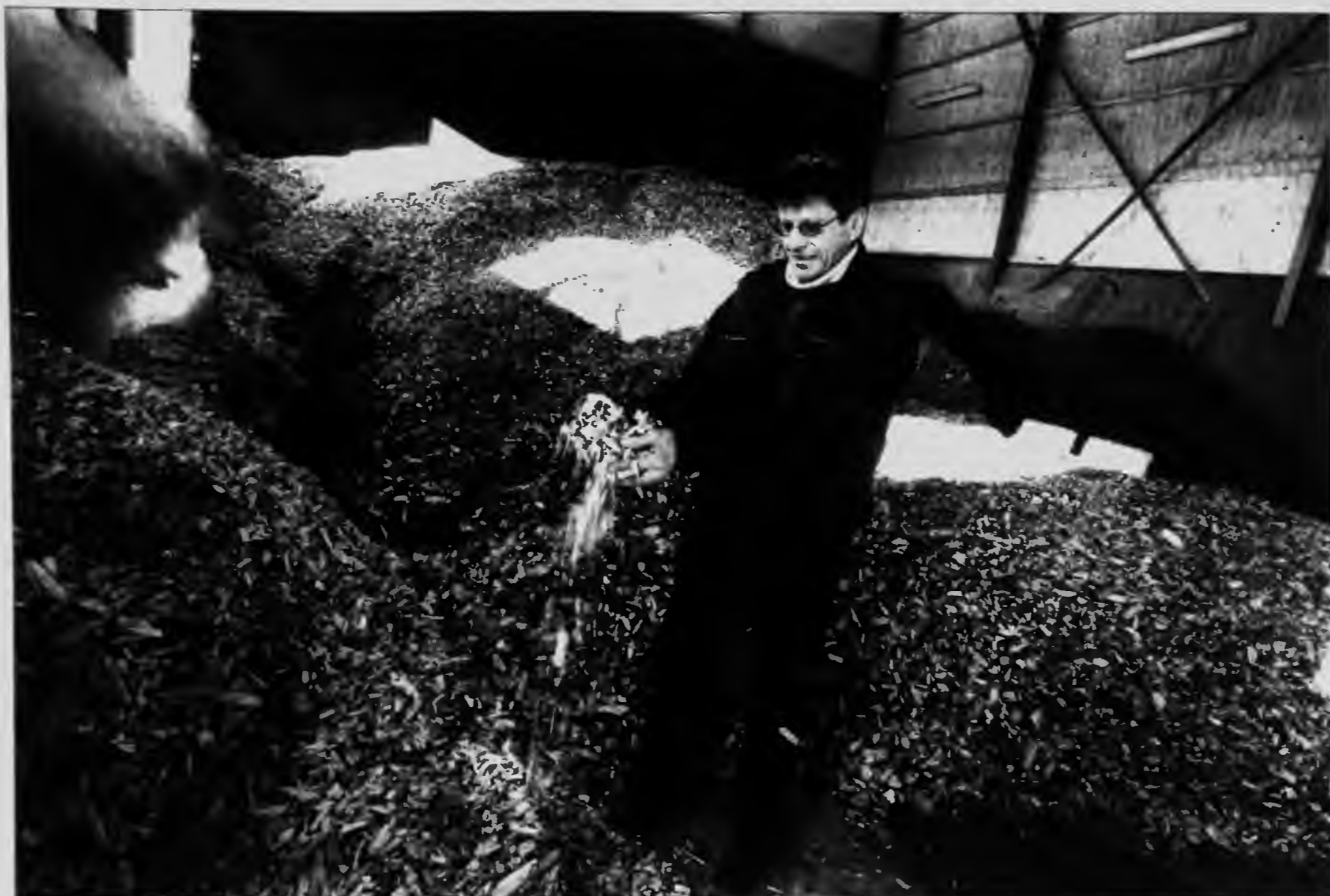
Kaj Rex vid Vörs energiandelslag är nöjd med investeringen i en ny fliscentral vid Norrvalla Folkhälsan. Lagret har kapacitet för 250 kubikmeter flis, och kräver inget manuellt arbete. Flisen matas in till pannrummet med hjälp av elevatorskruvar i golvet och rörliga sidopaneler. Pannan kan sluka 6 000 kubikmeter på ett år. Foto: Mikael Herrgård
